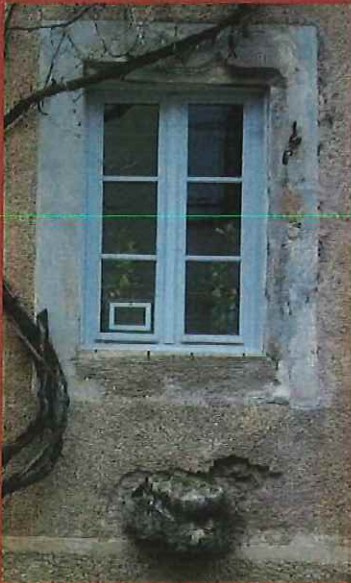
Gouttière de la pierre à eau sous la baie de la cuisine
